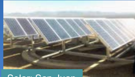
Solar: San Juan
